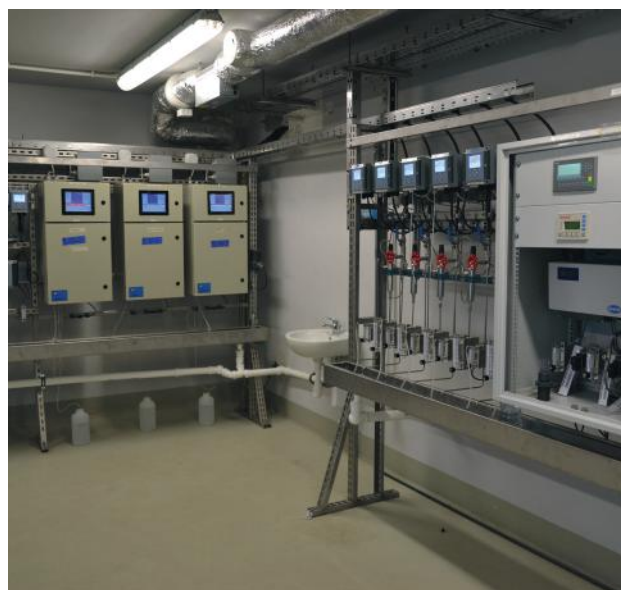
Kontrola jakości wody na stacji DEMI
