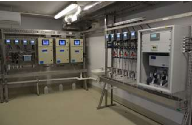
Kontrola jakości wody na stacji DEMI
