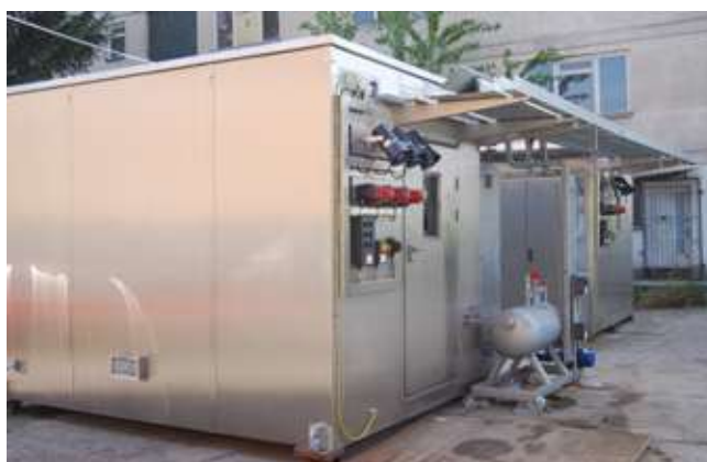
Kontenery z zestawem pomiarów fizykochemicznych wykonane do pracy w strefie zagrożonej wybuchem
