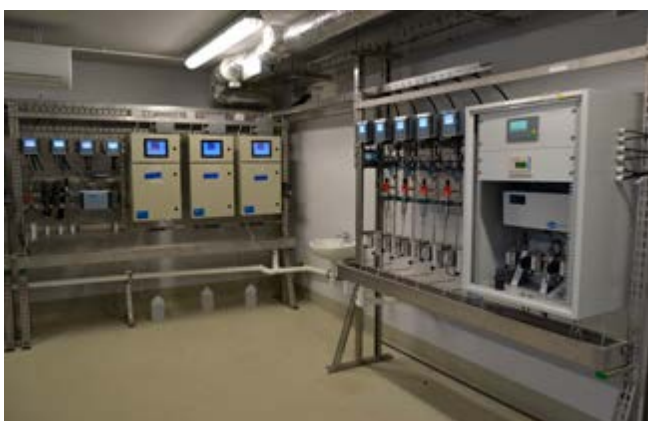
Kontrola jakości wody na stacji DEMI
