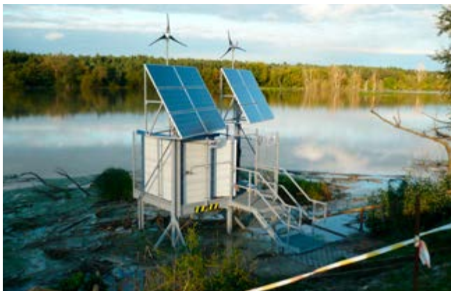
Stacja monitoringu wody zrzucanej do Wisty
