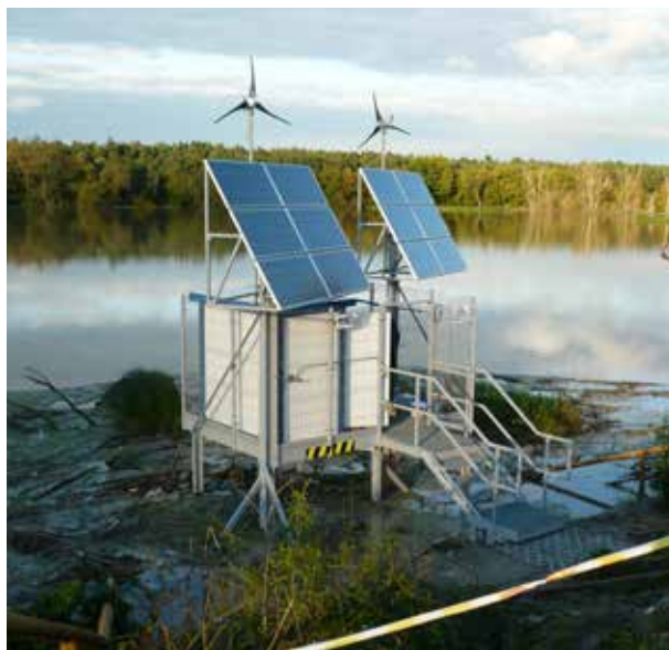
Stacja monitoringu wody zrzucanej do Wisty
